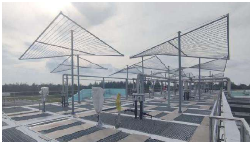
Gambar 54. Instalasi Pada WWTP Bengkong
