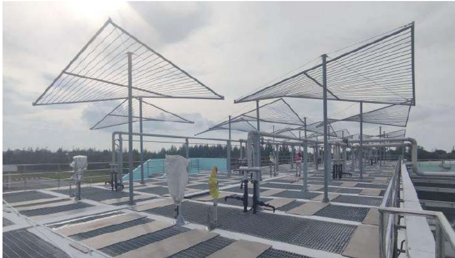
Gambar 4.2 Foto Instalasi Pada WWTP Bengkong
