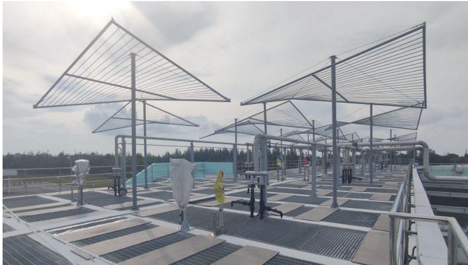
Gambar 4.2 Foto Instalasi Pada WWTP Bengkong
